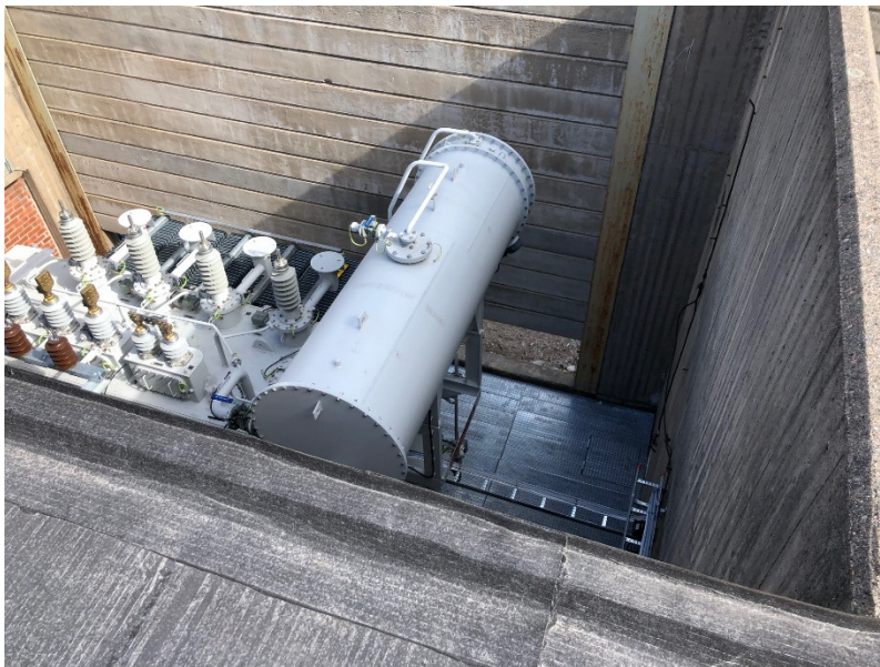
Figur 13. Foto från tak till transformatorstation.
