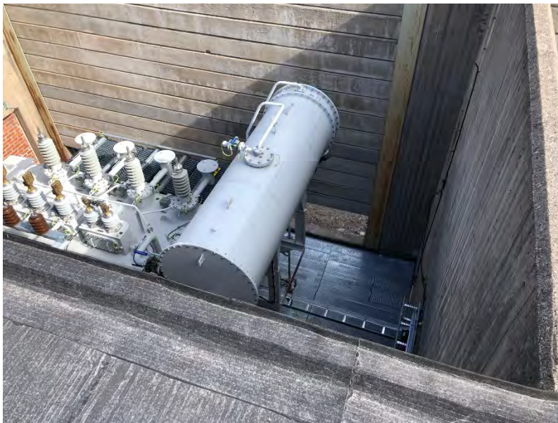
Figur 13. Foto från tak till transformatorstation.
